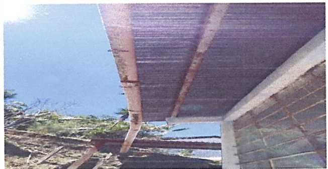
Foto 4: Cambio de canales en el lado lateral de la escuela.
